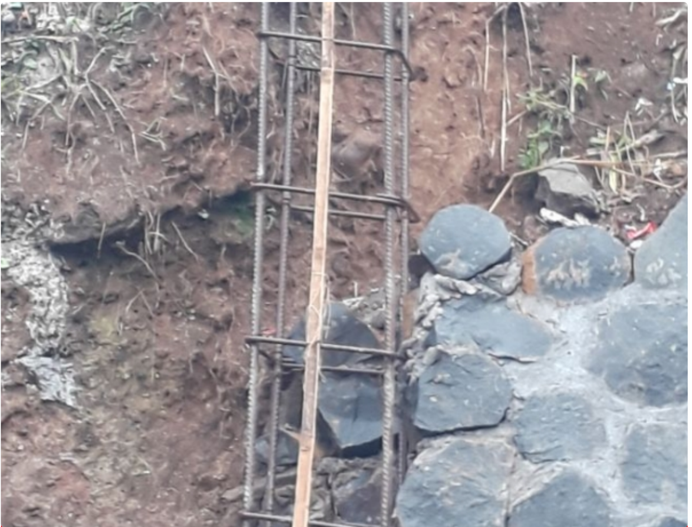
Besi baja tulangan beton DPT Cisalopa-Pasir Buncir yang terpasang tanpa kode BJTS/TS.
